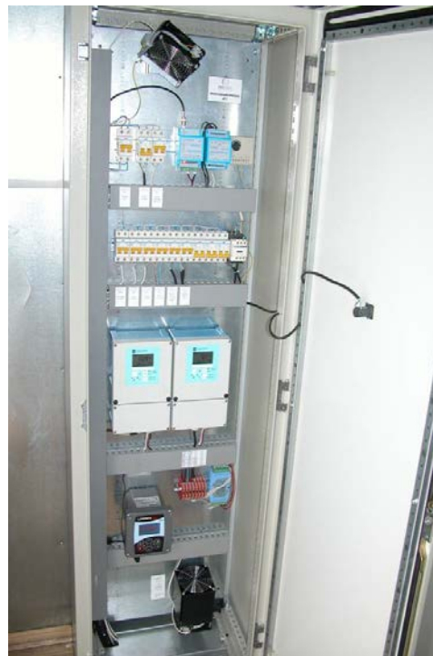
Шкаф приборов и оборудования связи.
