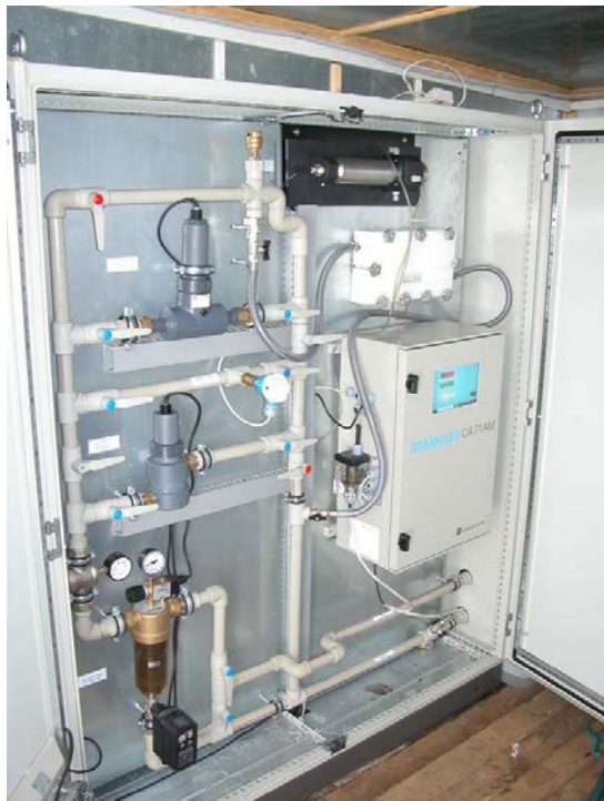
Аналитический шкаф, система пробоподготовки.
